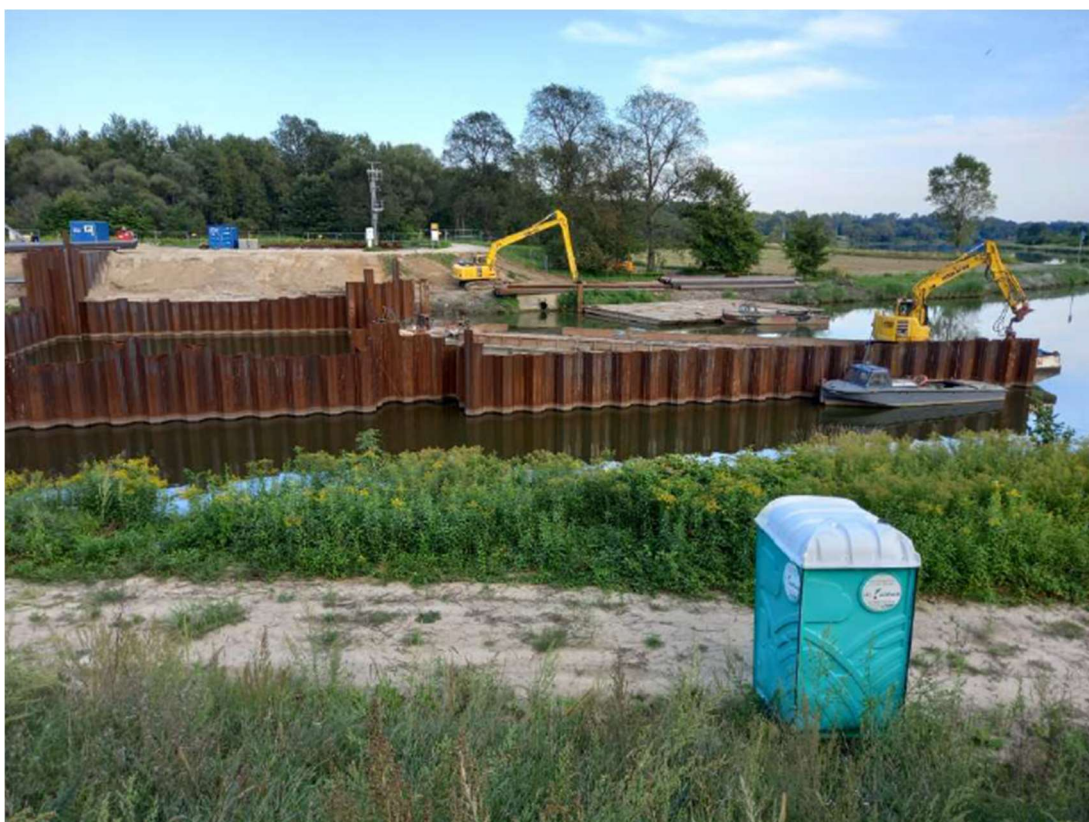
Foto. 18. Teren budowy bramy przeciwpowodziowej na kanale portu Kujawy, stan w trzeciej dekadzie sierpnia 2022 r. (widok z zachodniego brzegu, w dół kanału).
