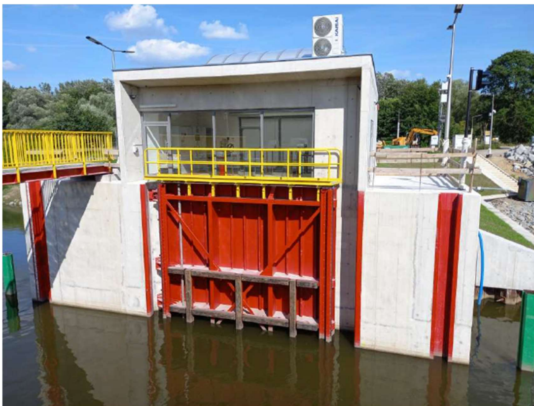
Foto. 27. Teren budowy bramy przeciwpowodziowej na kanale portu Kujawy – część środkowa, stan w trzeciej dekadzie lipca 2023 r. (widok w kierunku wschodnim).
