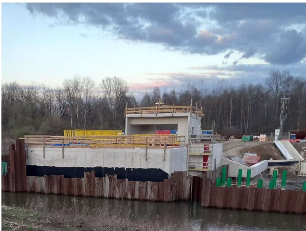
Foto. 23. Teren budowy bramy przeciwpowodziowej na kanale portu Kujawy – część środkowa, stan w trzeciej dekadzie marca 2023 r. (widok z zachodniego brzegu, w kierunku wschodnim).
