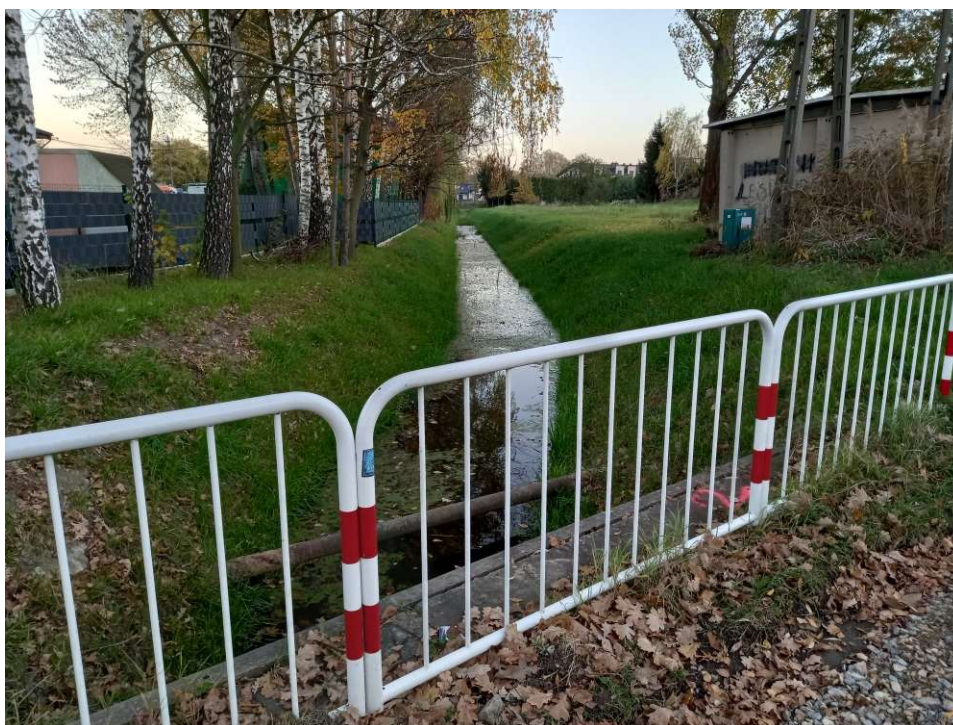
Foto. 38. Porost traw na skarpach brzegowych na Rowie 2 po zakończeniu robót na tym odcinku, (widok w kierunku wschodnim).
