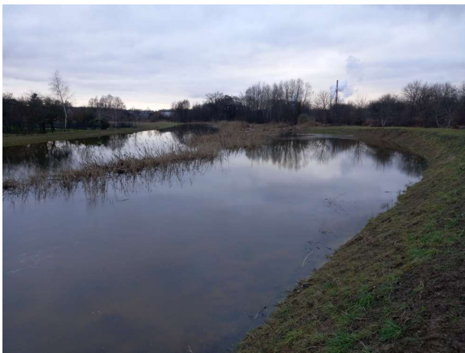
Foto. 52. Stan terenu budowy w ostatnim miesiącu okresu realizacji robót – przebudowywany zbiornik na Rowie 2, część zachodnia, stan w trzeciej dekadzie stycznia 2023 r. (widok w kierunku zachodnim).
