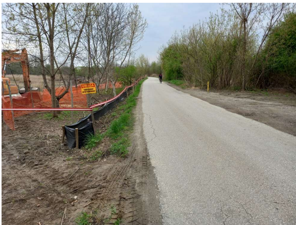
Foto. 22. Wygrodzenie teren budowy wzdłuż ul. Odmętowej, stan w trzeciej dekadzie kwietnia 2022 r. (widok w kierunku zachodnim).
