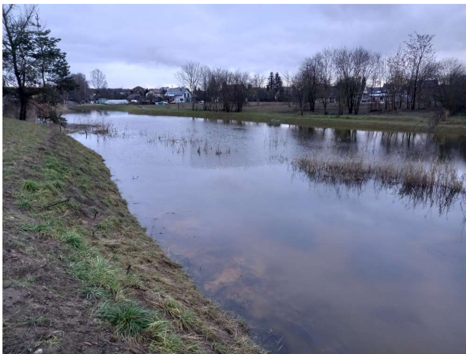
Foto. 51. Stan terenu budowy w ostatnim miesiącu okresu realizacji robót – przebudowywany zbiornik na Rowie 2, część wschodnia, stan w trzeciej dekadzie stycznia 2023 r. (widok w kierunku wschodnim).
