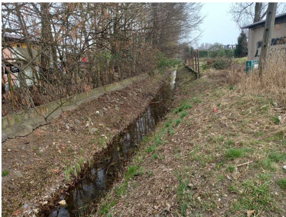
Foto. 15. Stan terenu budowy w pierwszym miesiącu okresu realizacji robót – przebudowywany odcinek Rowu 2 – część dolna, stan w trzeciej dekadzie marca 2022 r. (widok w kierunku wschodnim).
