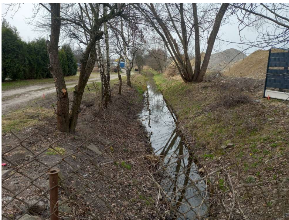
Foto. 16. Stan terenu budowy w pierwszym miesiącu okresu realizacji robót – przebudowywany odcinek Rowu 2 – część górna, stan w trzeciej dekadzie marca 2022 r. (widok w kierunku zachodnim).
