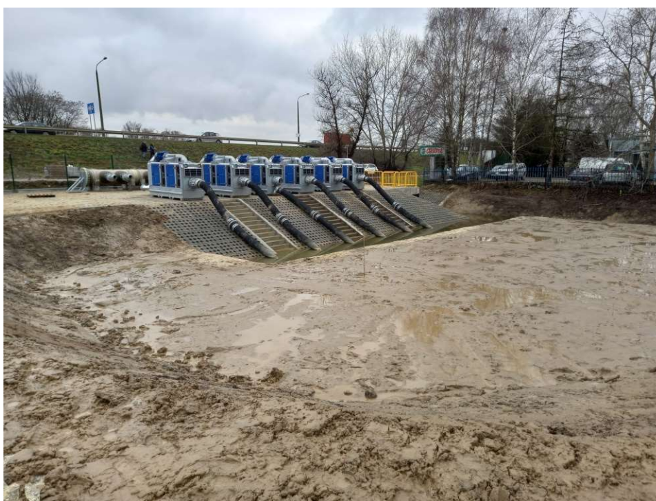
Foto. 46. Stan terenu budowy w ostatnim miesiącu okresu realizacji robót – teren budowy zbiornika retencyjnego powyżej śluzy wałowej oraz stanowiska pompowego dla pomp mobilnych, stan w trzeciej dekadzie stycznia 2023 r. (widok w kierunku południowym).
