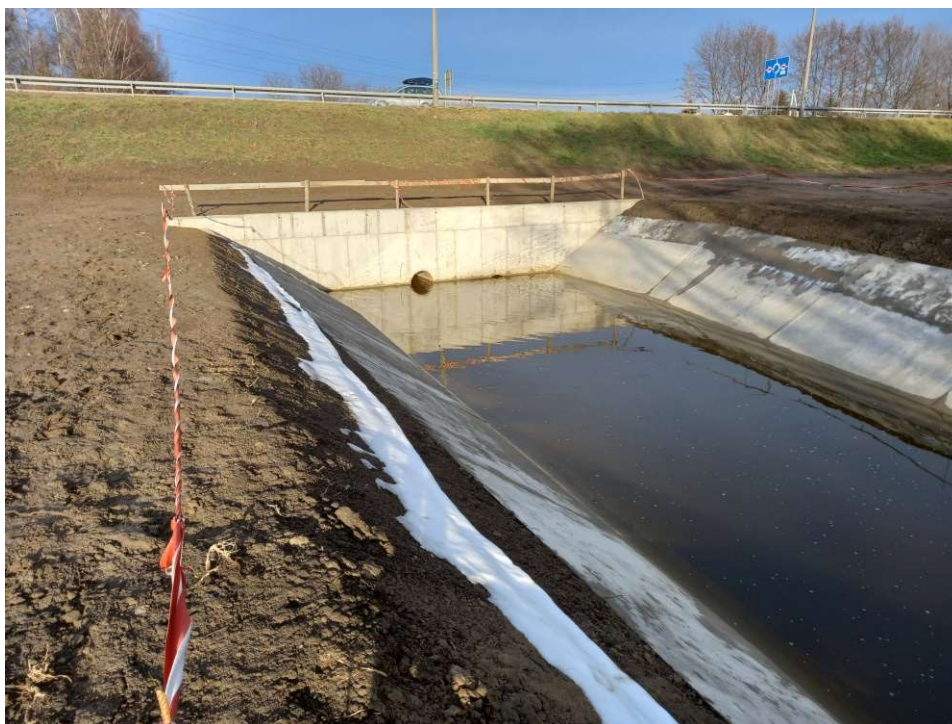
Foto. 23. Zabezpieczenie miejsc niebezpiecznych na terenie budowy śluzy wałowej na Rowie 2a na międzywalu Wisły, stan w trzeciej dekadzie grudnia 2022 r. (widok w kierunku północnym).
