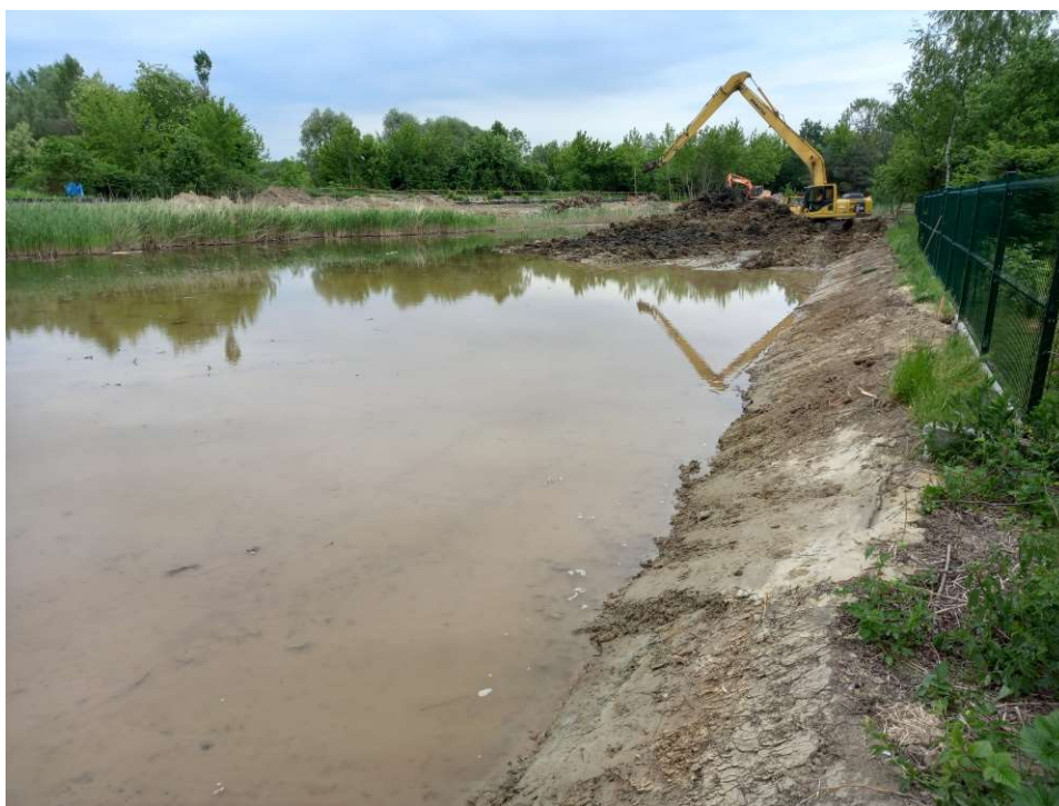
Foto. 40. Roboty ziemne na południowym brzegu powiększanego zbiornika na Rowie 2, stan w trzeciej dekadzie maja 2022 r. (widok w kierunku wschodnim).
