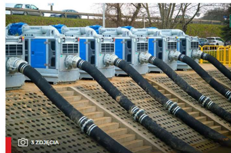
• Pompownia Lesisko (Jan Lorek)
