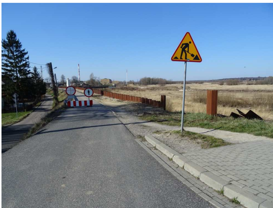
Foto. 15. Oznakowanie drogi publicznej w pobliżu wyjazdu z terenu robót – wał opaskowy w ciągu ul. Mostowej, stan w trzeciej dekadzie marca 2020 r. (widok w kierunku SW).
