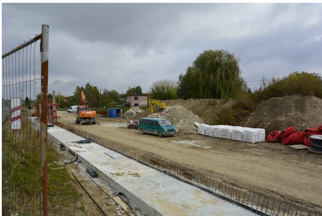
Foto. 10. Plac składowy przy wale opaskowym w ciągu ul. Portowej, stan w drugiej dekadzie października 2021 r. (widok w kierunku NE).
