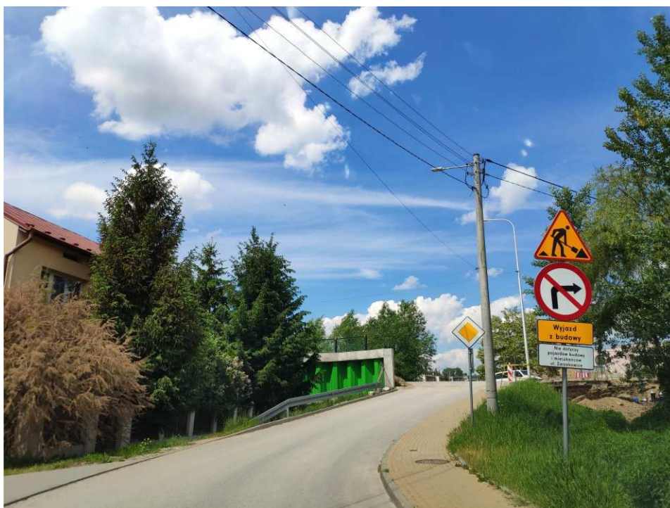
Foto. 16. Oznakowanie drogi publicznej w pobliżu wyjazdu z terenu robót – wał opaskowy w ciągu ul. Zarzekowice, stan w trzeciej dekadzie maja 2022 r. (widok w kierunku SW).
