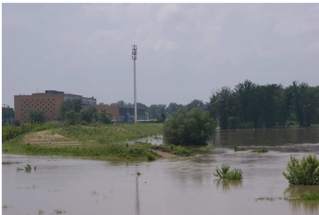
Foto. 42. Wezbranie powodziowe na terenie robót – prawobrzeżny wał rzeki Wisły wzdłuż brzegu basenu portowego, stan w trzeciej dekadzie czerwca 2020 r. (widok w kierunku SW).
