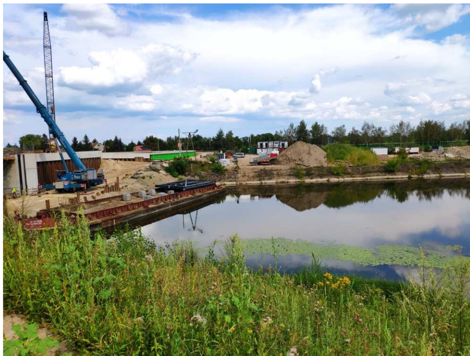
Foto. 47. Brak ingerencji w środowisko wodne poza granicami terenu robót – brama przeciwpowodziowa na kanale portowym w Sandomierzu, stan w pierwszej dekadzie sierpnia 2022 r. (widok w kierunku SE).
