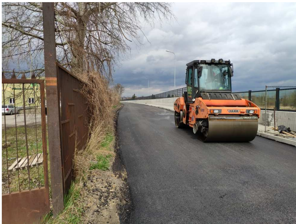
Foto. 37. Budowa drogi na wale opaskowym – wał opaskowy w ciągu ul. Mostowej, stan w pierwszej dekadzie kwietnia 2022 r. (widok w kierunku NE).
