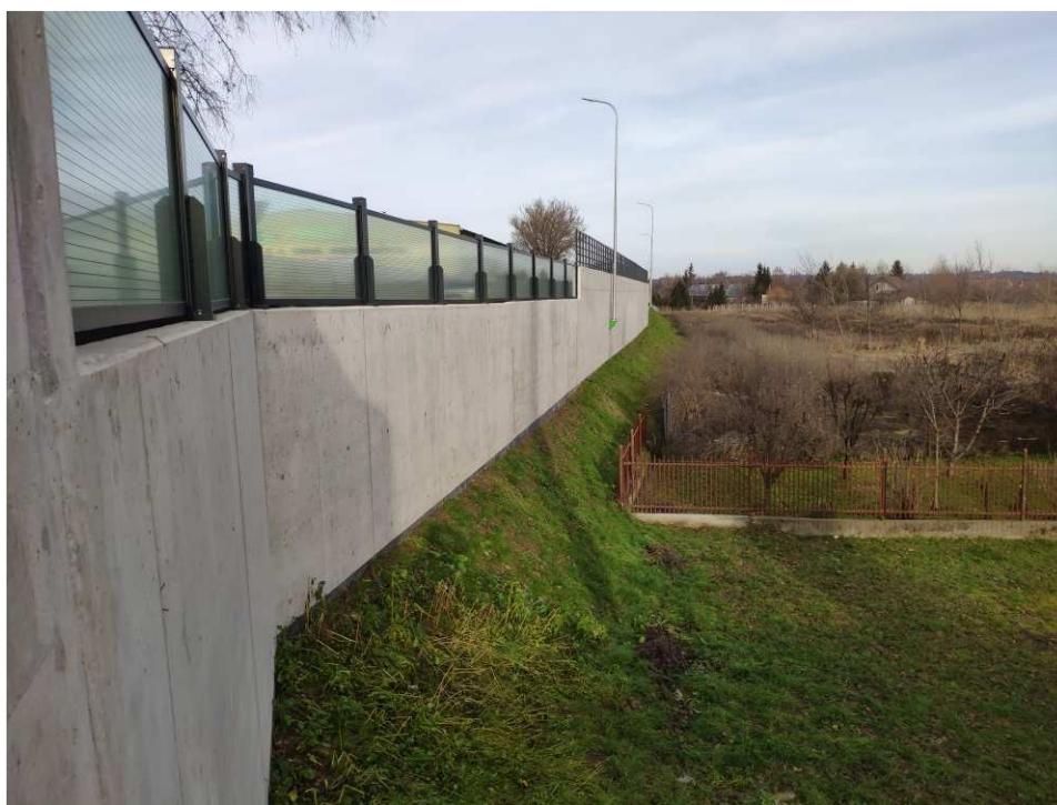
Foto. 51. Stan terenu budowy w ostatnim kwartale okresu realizacji robót na Zadaniu 3 – wał opaskowy w ciągu ul. Mostowej, stan w trzeciej dekadzie grudnia 2022 r. (widok w kierunku NE).
