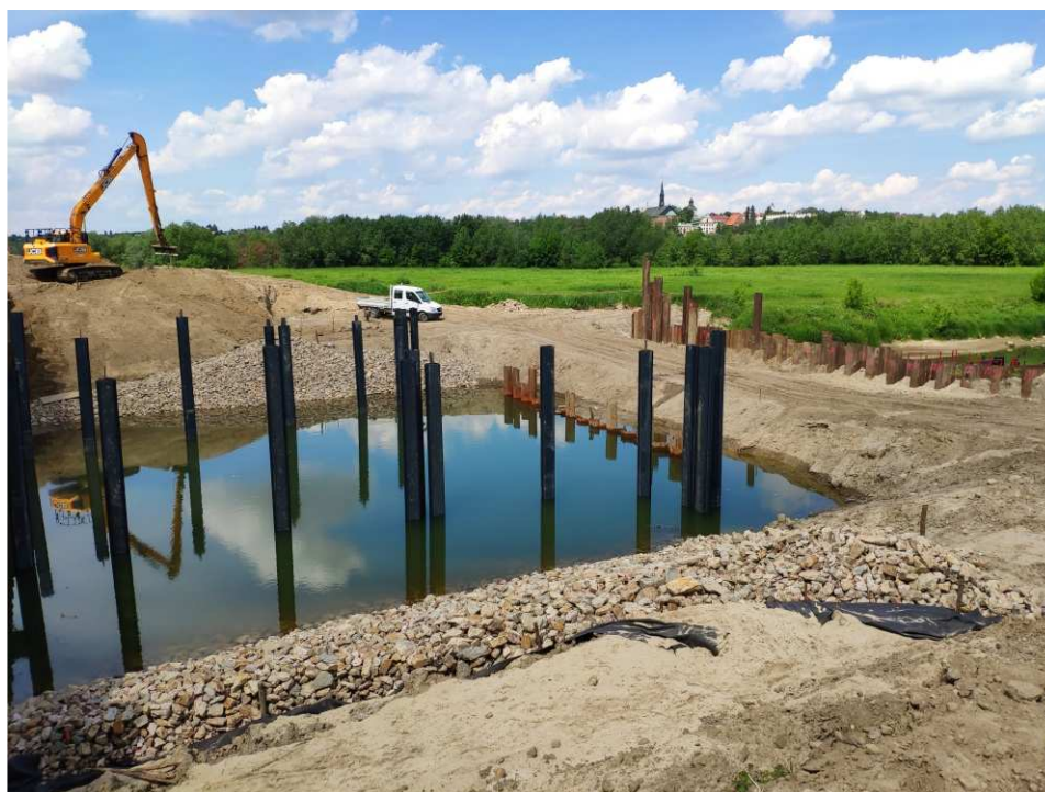
Foto. 46. Roboty w korycie kanału pod osłoną ścianek szczelnych – brama przeciwpowodziowa na kanale portowym w Sandomierzu, stan w trzeciej dekadzie maja 2022 r. (widok w kierunku NW).
