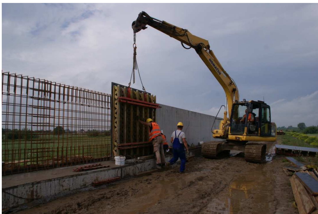
Foto. 28. Budowa muru oporowego żelbetowego – wał opaskowy pomiędzy ul. Zarzekowice a prawobrzeżnym wałem Wisły, stan w trzeciej dekadzie czerwca 2020 r. (widok w kierunku SW).
