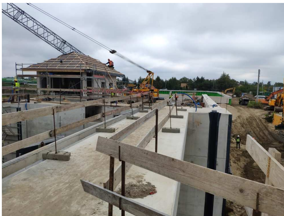
Foto. 13. Zabezpieczenie miejsc niebezpiecznych – brama przeciwpowodziowa na kanale portowym w Sandomierzu, stan w trzeciej dekadzie września 2022 r. (widok w kierunku SW).
