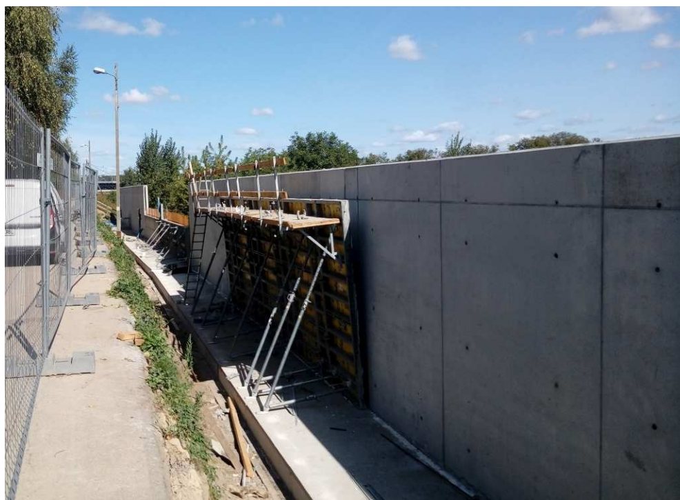
Foto. 27. Budowa muru oporowego żelbetowego – wał opaskowy w ciągu ul. Mostowej, stan w drugiej dekadzie września 2020 r. (widok w kierunku NE).
