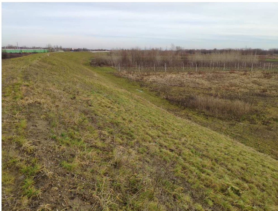
Foto. 55. Stan terenu budowy w ostatnim kwartale okresu realizacji robót na Zadaniu 3 – wał opaskowy pomiędzy ul. Zarzekowice a prawobrzeżnym wałem Wisły, stan w trzeciej dekadzie grudnia 2022 r. (widok w kierunku NE).
