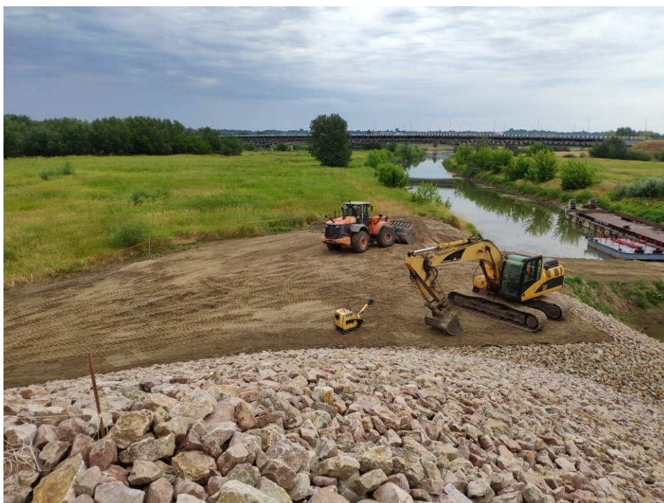
Foto. 48. Brak ingerencji w obszar Natura 2000 poza granicami terenu robót – brama przeciwpowodziowa na kanale portowym w Sandomierzu, stan w pierwszej dekadzie lipca 2022 r. (widok w kierunku NE).
