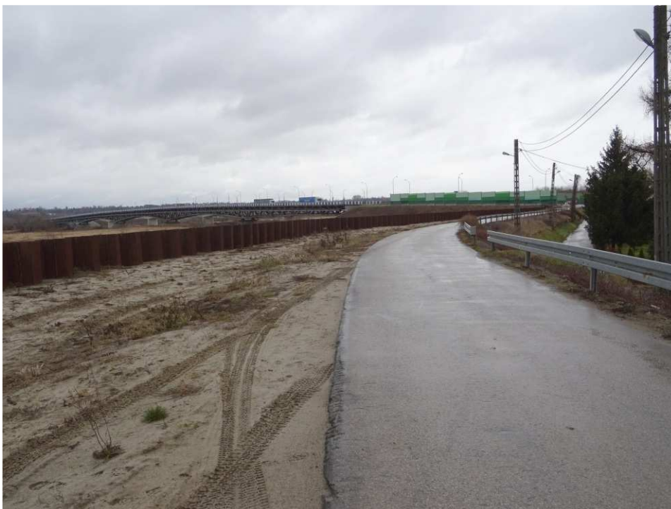
Foto. 2. Stan terenu budowy w pierwszym kwartale okresu realizacji robót na Zadaniu 3 – wał opaskowy w ciągu ul. Mostowej, stan w drugiej dekadzie lutego 2020 r. (widok w kierunku NE).
