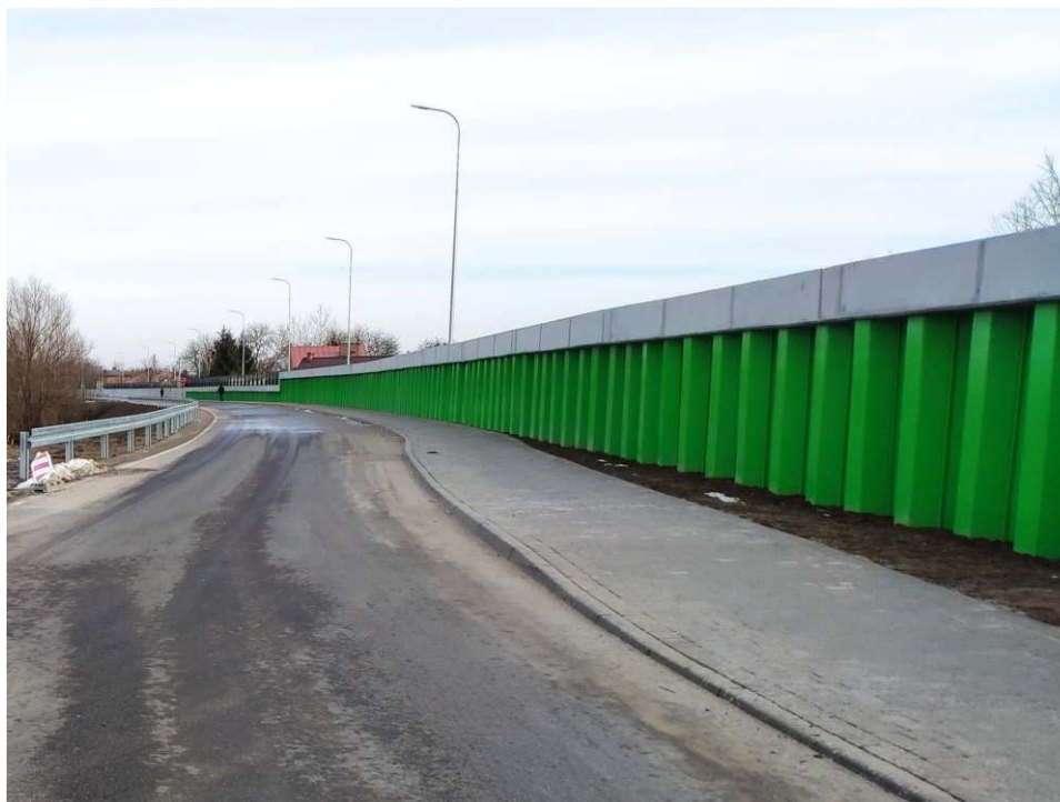
Foto. 53. Stan terenu budowy w ostatnim kwartale okresu realizacji robót na Zadaniu 3 – wał opaskowy w ciągu ul. Zarzekowice, stan w trzeciej dekadzie grudnia 2022 r. (widok w kierunku NE).
