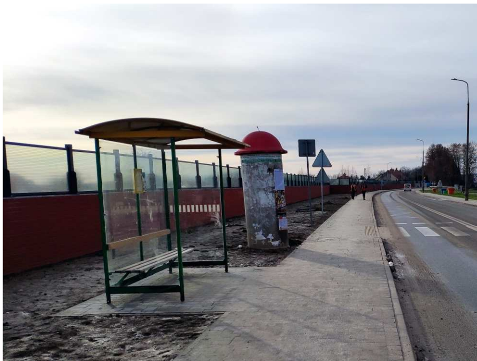
Foto. 52. Stan terenu budowy w ostatnim kwartale okresu realizacji robót na Zadaniu 3 – wał opaskowy w ciągu ul. Portowej, stan w trzeciej dekadzie grudnia 2022 r. (widok w kierunku SW).
