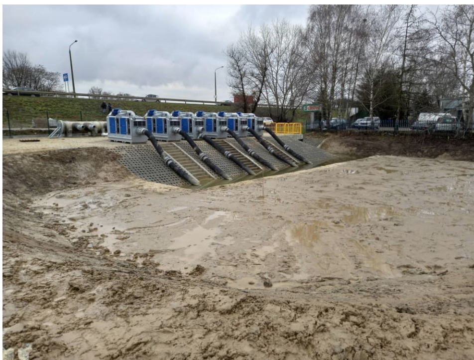
Foto. 52. Stan terenu budowy w ostatnim miesiącu okresu realizacji robót – teren budowy zbiornika retencyjnego powyżej śluzy wałowej oraz stanowiska pompowego dla pomp mobilnych, stan w trzeciej dekadzie stycznia 2023 r. (widok w kierunku południowym).
