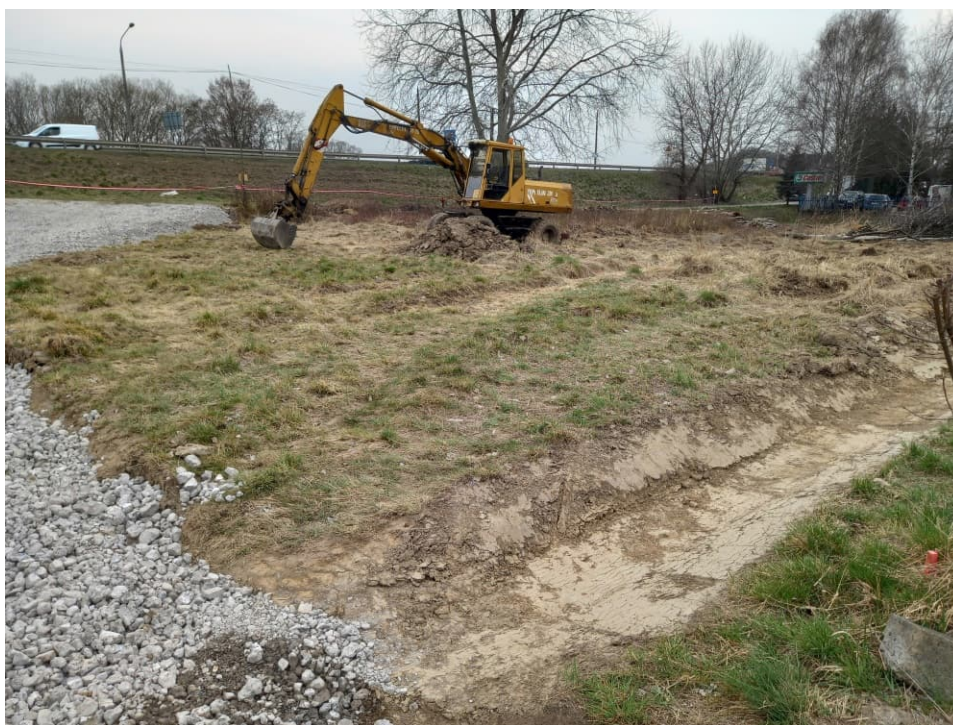
Foto. 4. Stan terenu budowy w pierwszym miesiącu okresu realizacji robót – teren budowy zbiornika retencyjnego powyżej śluzy wałowej oraz stanowiska pompowego dla pomp mobilnych, stan w trzeciej dekadzie marca 2022 r. (widok w kierunku południowym).
