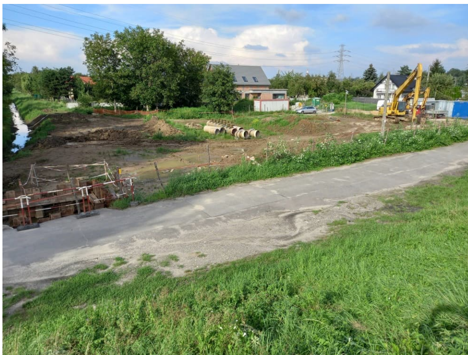
Foto. 35. Roboty ziemne przy budowie zbiornika retencyjnego na Rowie 2a, stan w trzeciej dekadzie sierpnia 2022 r. (widok w kierunku północnym).
