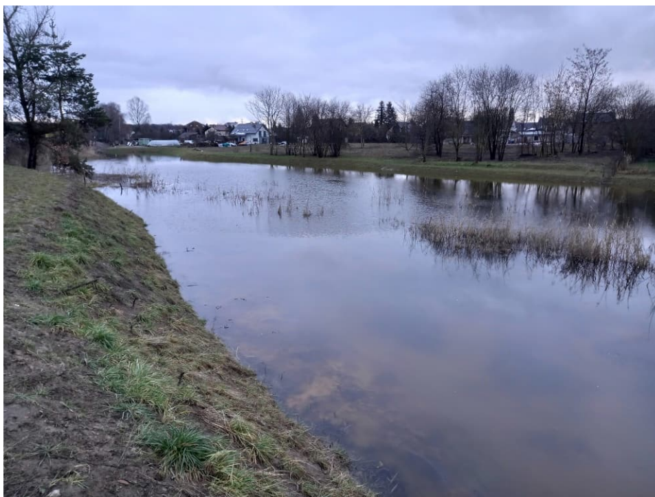
Foto. 57. Stan terenu budowy w ostatnim miesiącu okresu realizacji robót – przebudowywany zbiornik na Rowie 2, część wschodnia, stan w trzeciej dekadzie stycznia 2023 r. (widok w kierunku wschodnim).
