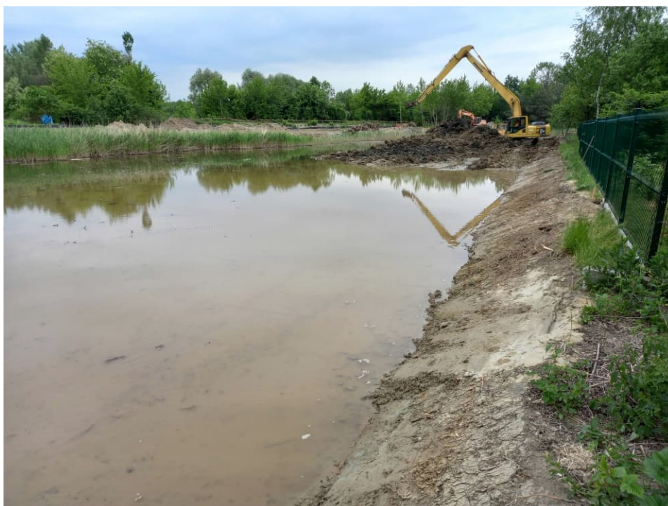
Foto. 46. Roboty ziemne na południowym brzegu powiększanego zbiornika na Rowie 2, stan w trzeciej dekadzie maja 2022 r. (widok w kierunku wschodnim).
