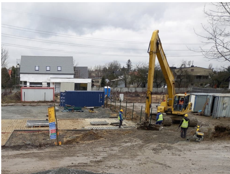
Foto. 40. Rekultywacja terenu w otoczeniu placu manewrowego i stanowiska pomp mobilnych na Rowie 2a, stan w trzeciej dekadzie stycznia 2023 r. (widok w kierunku północnym).
