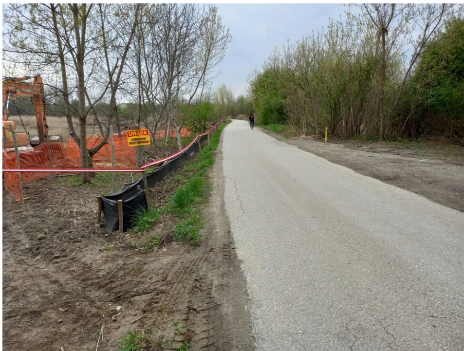
Foto. 20. Wygradzenie terenu budowy wzdłuż ul. Odmętowej, stan w trzeciej dekadzie kwietnia 2022 r. (widok w kierunku zachodnim).
