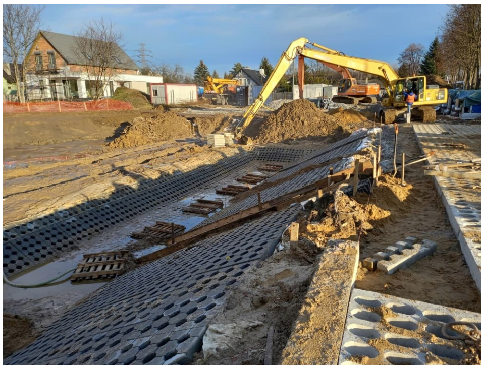
Foto. 37. Budowa stanowiska pomp mobilnych na Rowie 2a, stan w trzeciej dekadzie grudnia 2022 r. (widok w kierunku wschodnim).
