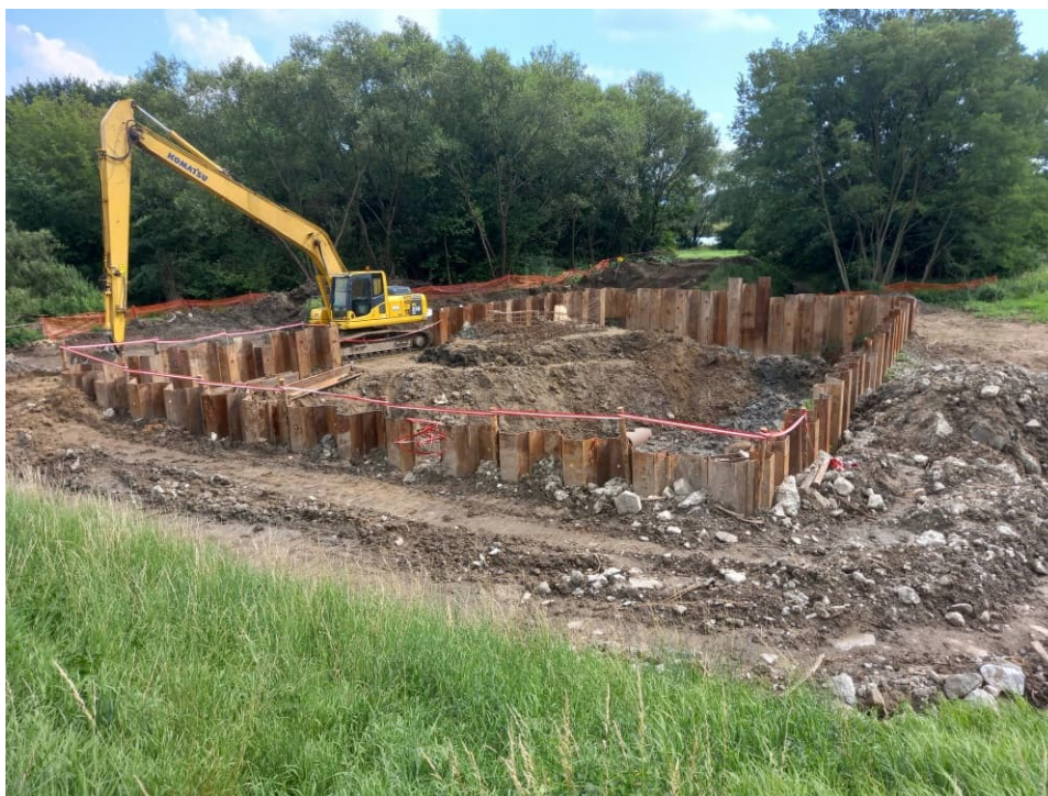
Foto. 31. Roboty ziemne na dolnym stanowisku śluzy wałowej na Rowie 2a, stan w trzeciej dekadzie lipca 2022 r. (widok w kierunku południowym).
