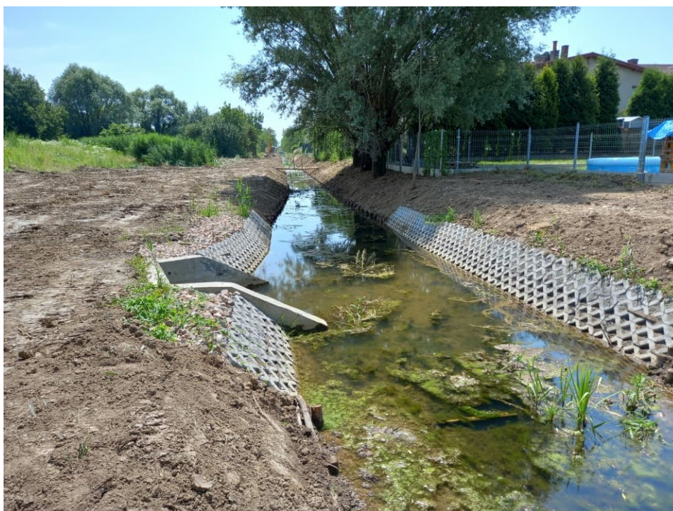
Foto. 42. Ubezpieczenie skarp brzegowych na Rowie 2a, stan w trzeciej dekadzie września 2022 r. (widok w kierunku południowym).
