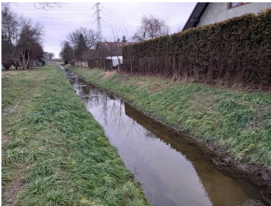
Foto. 53. Stan terenu budowy w ostatnim miesiącu okresu realizacji robót – przebudowywany odcinek Rowu 2a – część dolna, stan w trzeciej dekadzie stycznia 2023 r. (widok w kierunku południowym).
