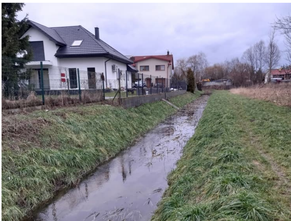
Foto. 54. Stan terenu budowy w ostatnim miesiącu okresu realizacji robót – przebudowywany odcinek Rowu 2a – część górna, stan w trzeciej dekadzie stycznia 2023 r. (widok w kierunku północnym).
