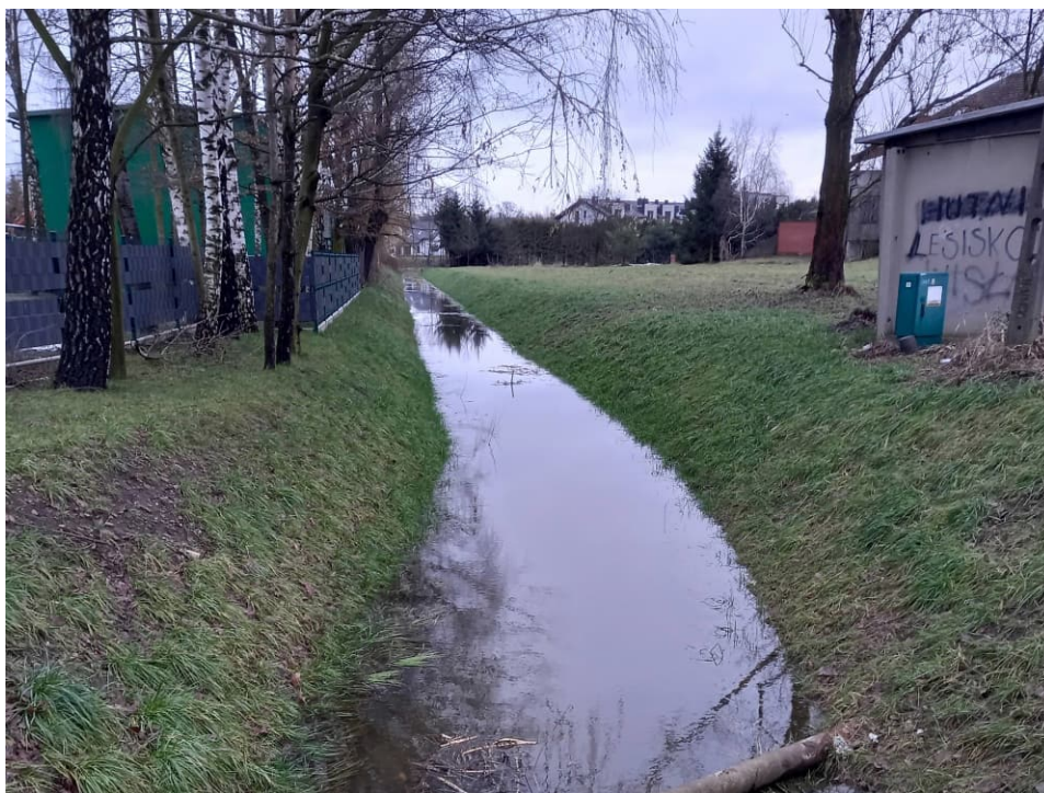
Foto. 55. Stan terenu budowy w ostatnim miesiącu okresu realizacji robót – przebudowywany odcinek Rowu 2 – część dolna, stan w trzeciej dekadzie stycznia 2023 r. (widok w kierunku wschodnim).
