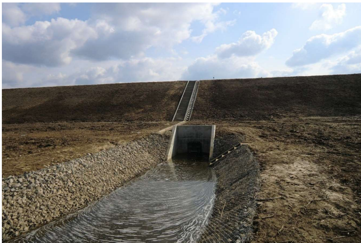
Fot. 4. Fragment korony i skarpy odpowietrznej wału wraz z wlotem do śluzy wałowej (Sekcja I km 4+093 wlot do śluzy) (źródło: zasoby własne AECOM Polska Sp. z o.o.).
