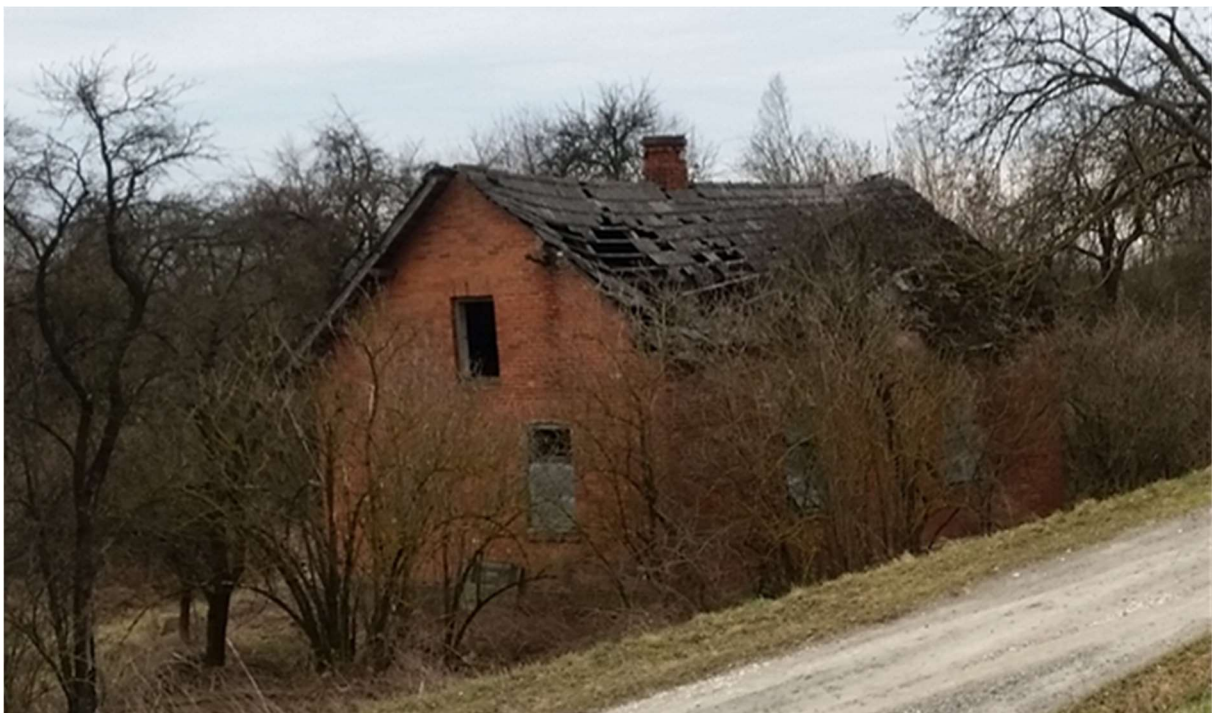
Fot. 1. Opuszczona ruina budynku (dz. 975 obręb Wrzawy) – ruina, której stan zagrażał bezpieczeństwu ludzi została rozebrana - km 1+730 Sekcja II.
