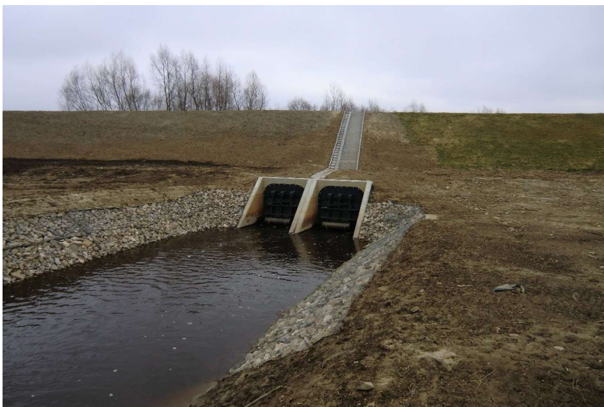
Fot. 5. Fragment korony i skarpy odpowietrznej wału wraz z wlotem do śluzy wałowej (Sekcja I km 6+200 wlot do śluzy) (źródło: zasoby własne AECOM Polska Sp. z o.o.).
