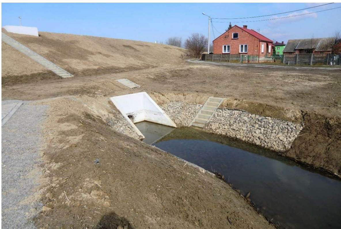
Fot. 3. Zrealizowana przebudowa przepustu wałowego (Sekcja I km 2+520 wlot do śluzy) (źródło: zasoby własne AECOM Polska Sp. z o.o.).
