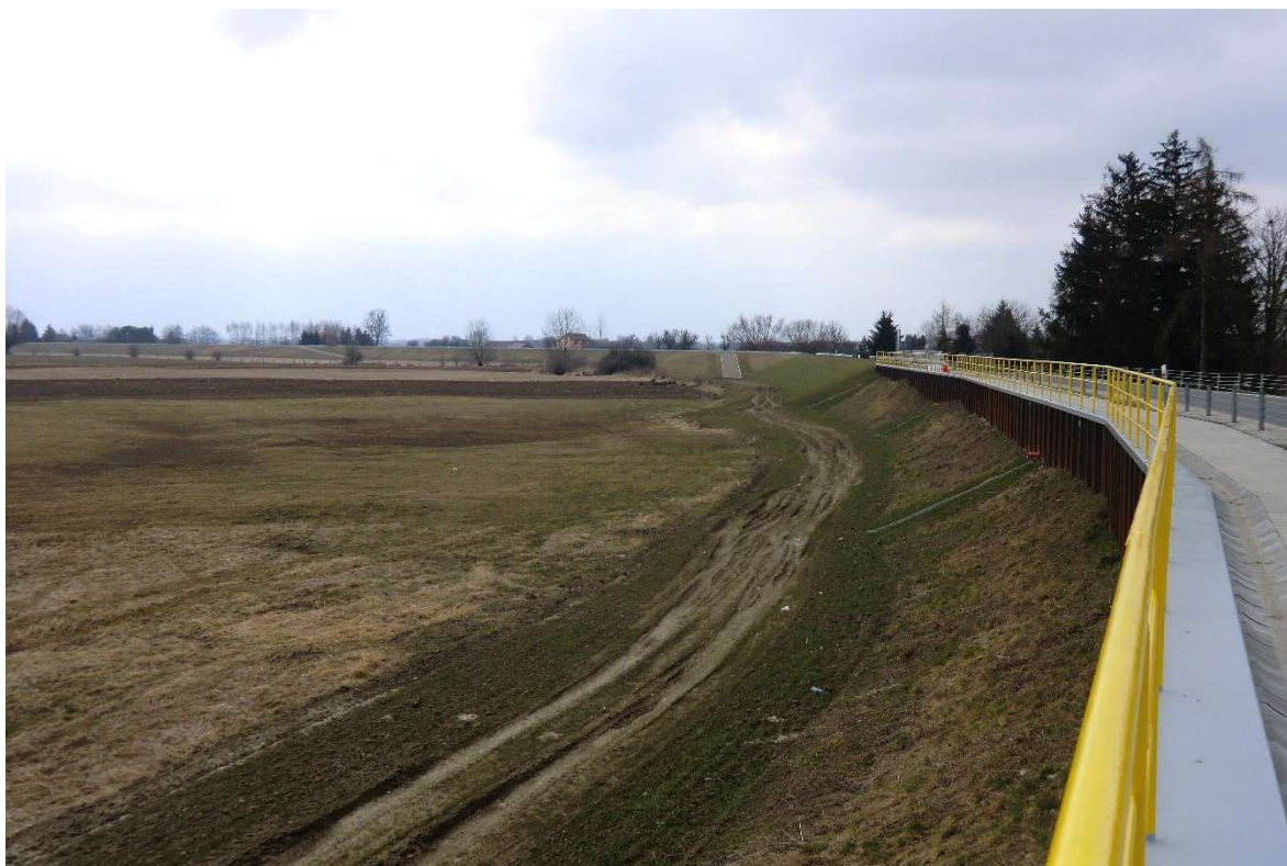
Fot. 4. Zrealizowana przebudowa wału (San III km 3.4 – podwyższenie rzędnych korony wału poprzez mur oporowy z oczepem i barierą zabezpieczającą) (źródło: zasoby własne Aecom Polska Sp. z o.o.).
