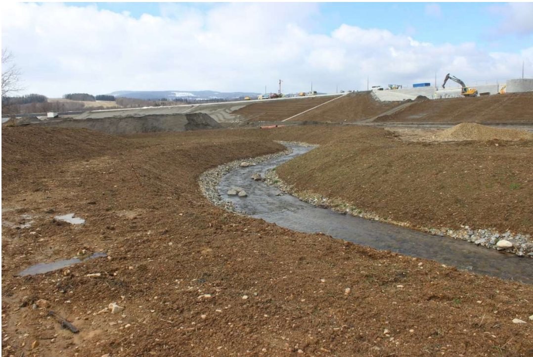
Fot.2. Nowe koryto potoku Nowinka, skarpy potoku zostały zahumusowane i obsiane mieszanką traw – etap realizacji Kontraktu.
