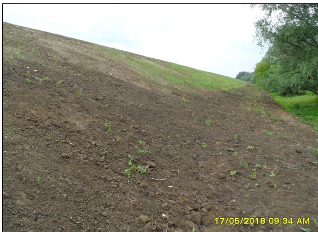
Fot. 27. Stopa skarpy odwodnej wału po obsiewie, ok. km 9+600 (maj 2018).
