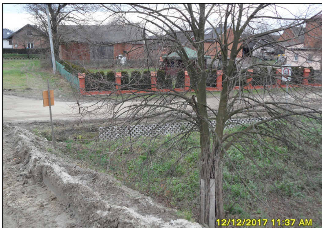
Fot. 3. Osłona drzewa w sąsiedztwie wału, ok. km 7+650 (grudzień 2017).
