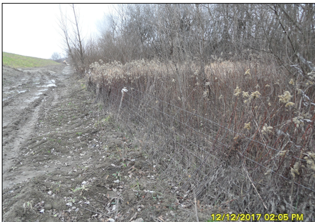
Fot. 10. Metalowa siatka ogrodzeniowa po stronie międzywału, ok. km 13+840 (grudzień 2017).
