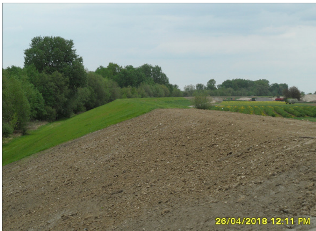
Fot. 17. Skarpa odwodna wału, ok. km 10+950 (kwiecień 2018).
